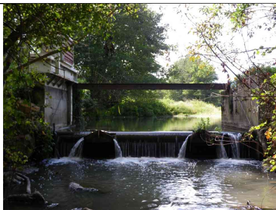
Vanne clapet sur le Renon
