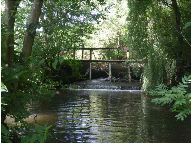
Vannage d'alimentation du bras de décharge du Moulin du Roy
