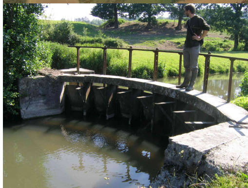
Vannage d'alimentation du canal d'amenée du moulin Maillet
