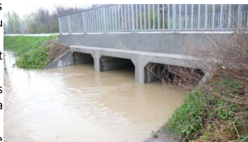
Figure 15: Mise en charge du dalot de Bettant (créé en 2006) lors de la crue d'avril 2008
