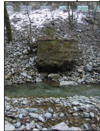
Affouillement d'un épi par usure et enfoncement du lit (~1 m)
