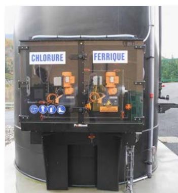
Stockage du chlorure ferrique permettant le traitement du phosphore à la station d'épuration du Cheylard. (© M. Chouteau)
