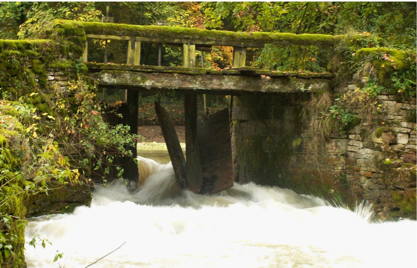
FIGURE 32: VANNES HORS D'USAGE
