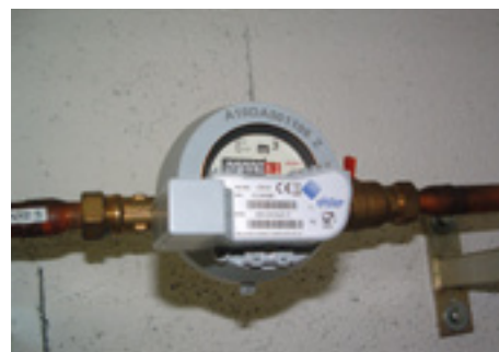
Compteur d'eau d'un abonné (source : OIEau)
