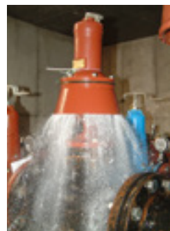
Soupape de décharge en fonctionnement (source : OIEau)
