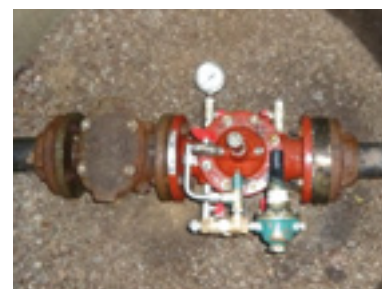
Vanne de régulation de pression (source : OIEau)
