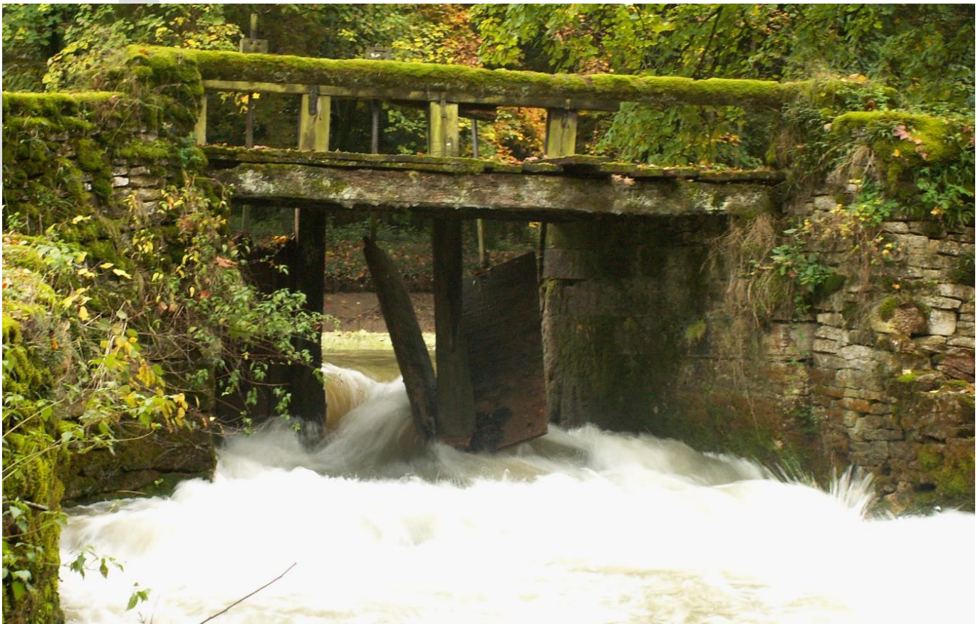
FIGURE 46: VANNES HORS D'USAGE SUR L'IGNON
