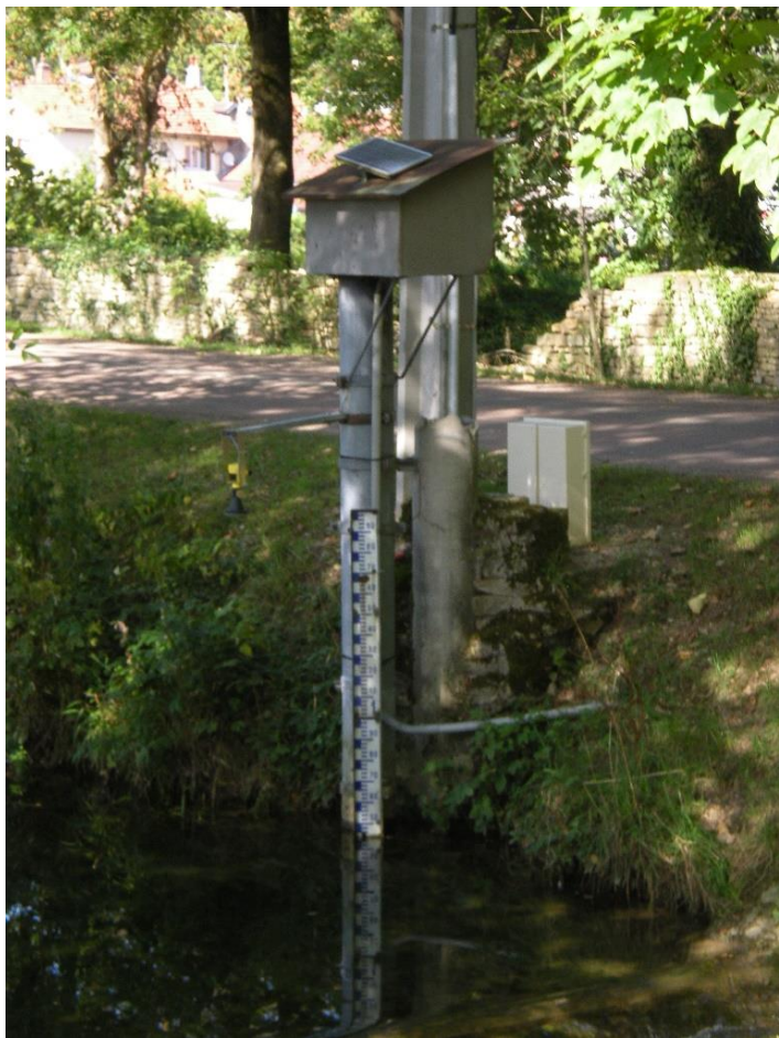
FIGURE 2: STATION HYDROMETRIQUE SUR LA VENELLE A SELONGEY
