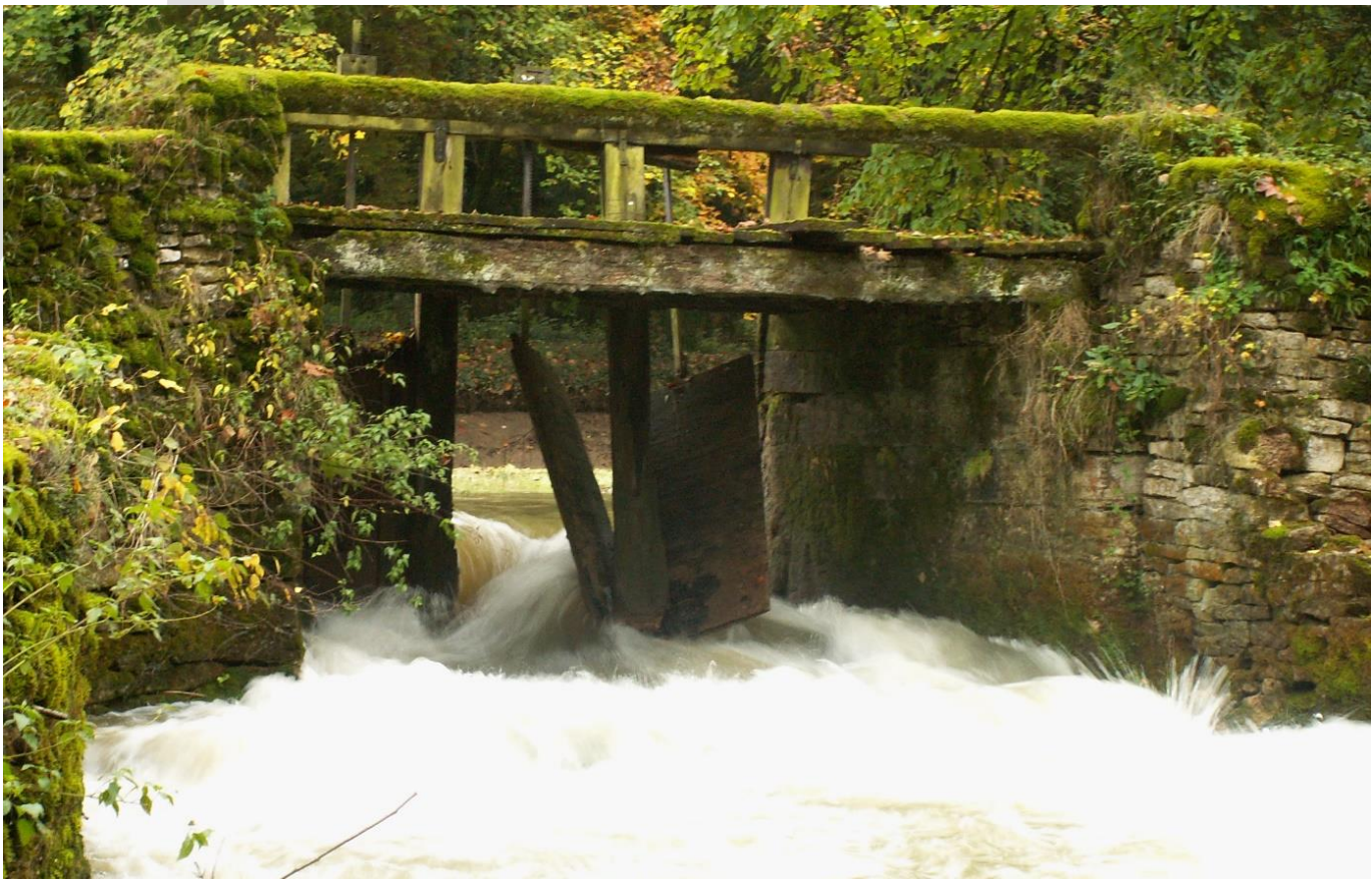
FIGURE 32: VANNES HORS D'USAGE
