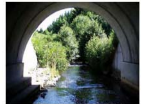
Passage à loutre sur la Cildane (commune de Saint-Julien-Puy-Lavèze) (RN 89). Aménagement efficace de banquettes latérales à l'intérieur de l'ouvrage le long de la paroi.
