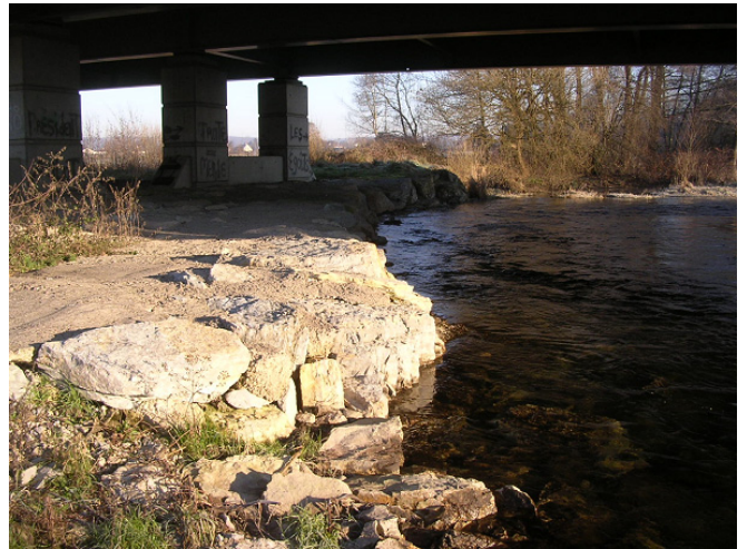
Figure 76 : Point dur constitué par la déviation de la N57 à Saint-Sauveur
