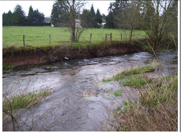
Figure 97 : Erosion en aval immédiat d'un seuil en travers
