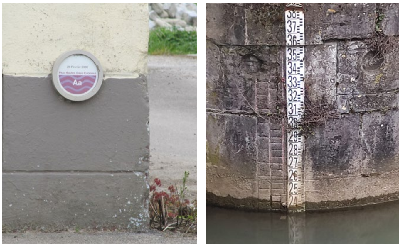
Photo 12 : Repère de crue et échelle limnimétrique
