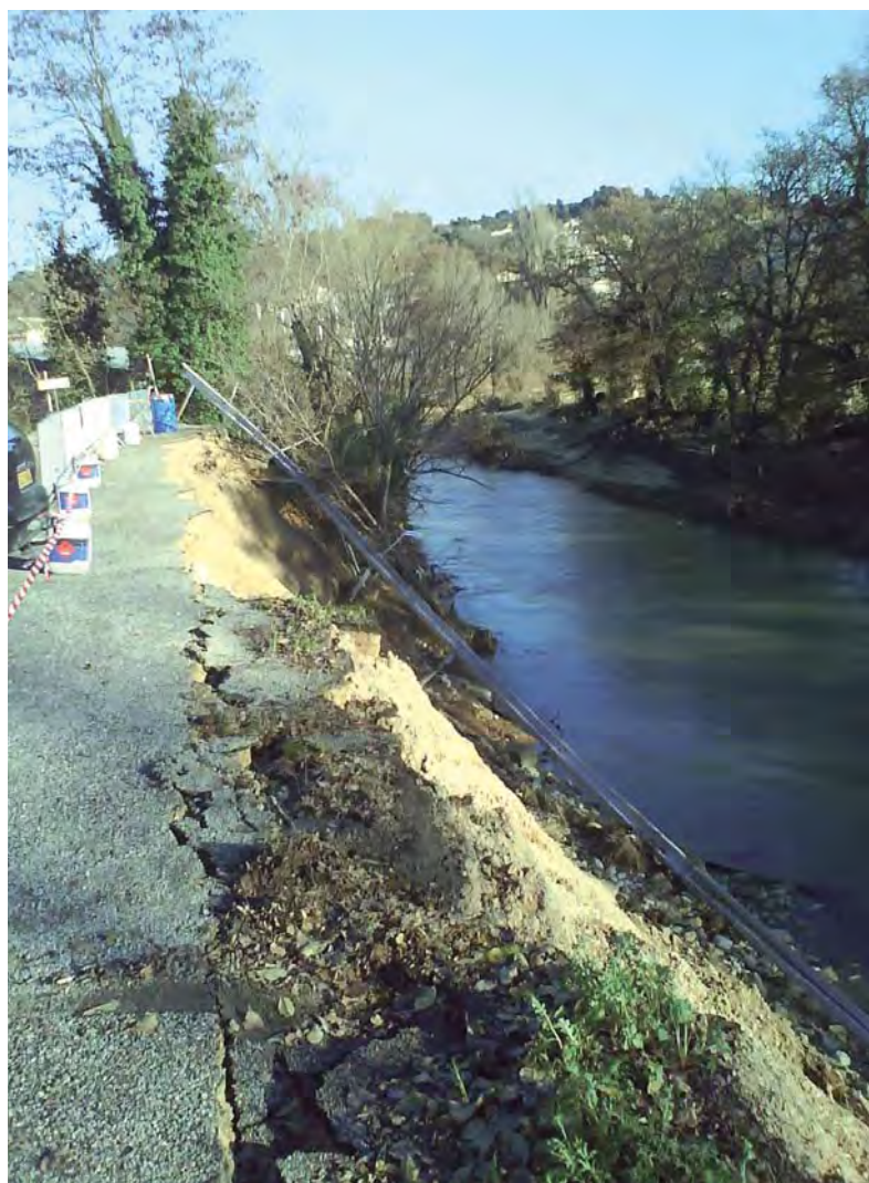
Érosion de berges à proximité d'un parking
