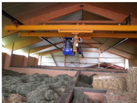
Système de séchage en grange
