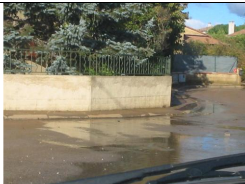
Enclos des Ormilles, traces du niveau d'eau, 17 novembre 2011
