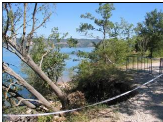
Erosion de berges à Bauduen
