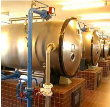
Figure 20 : ligne d’ozoneurs à l’usine d’Annet sur Marne (Veolia Eau)
