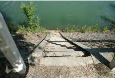
Escaliers abrupts à Créteil entre Maisons-Alfort et le Bras du Chapitre UFC Que choisir©
