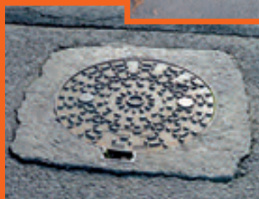
Grille d'eaux pluviales
