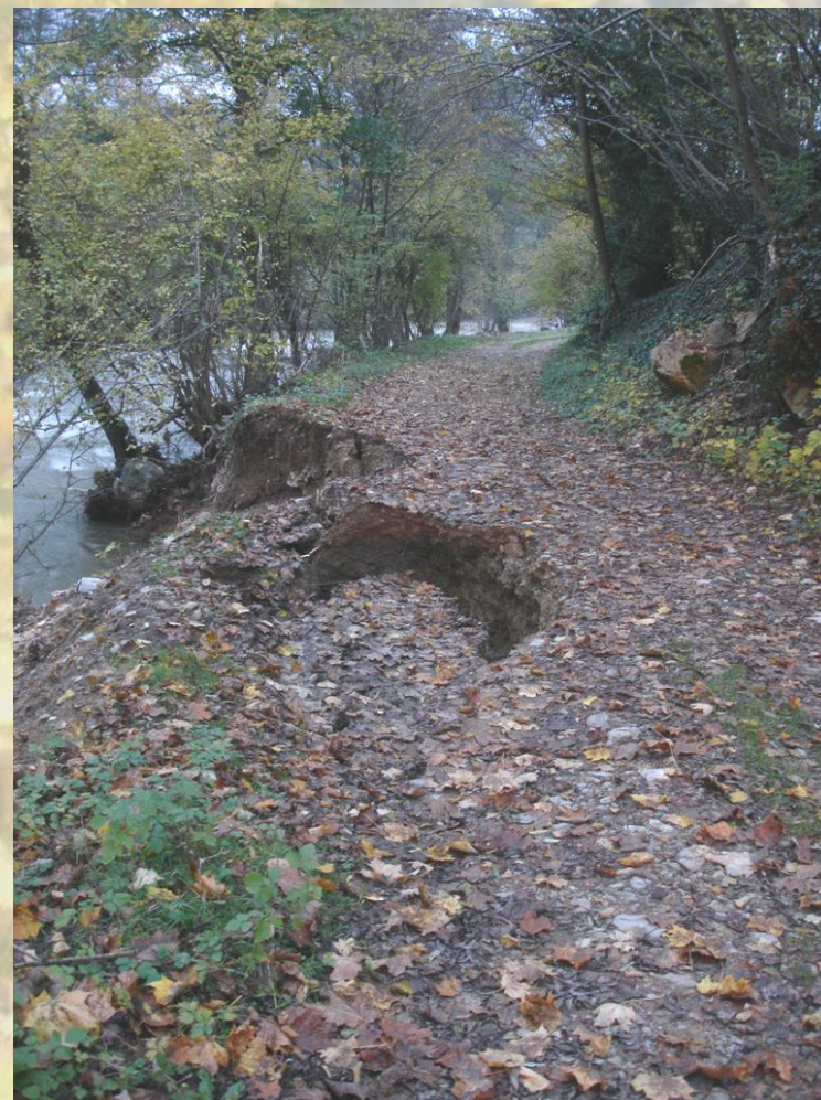
Affaissement des talus de berges
