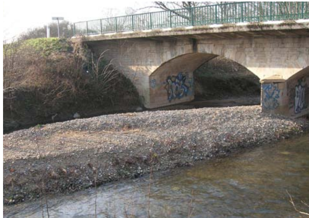
Dépôt alluvionnaire, Ardières, SMRB, 2006
