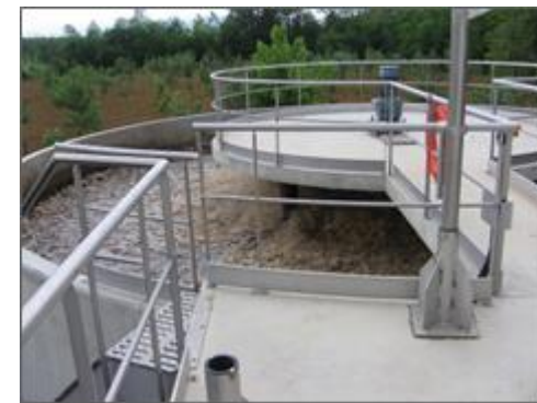
Station d'épuration de Cormoranche-sur-Saône (01)
