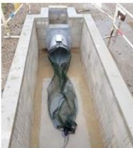
Exemple de filet installé en ligne (© Hydroconcept)
