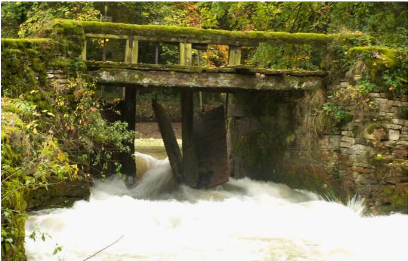
FIGURE 47: VANNES HORS D'USAGE SUR L'IGNON
