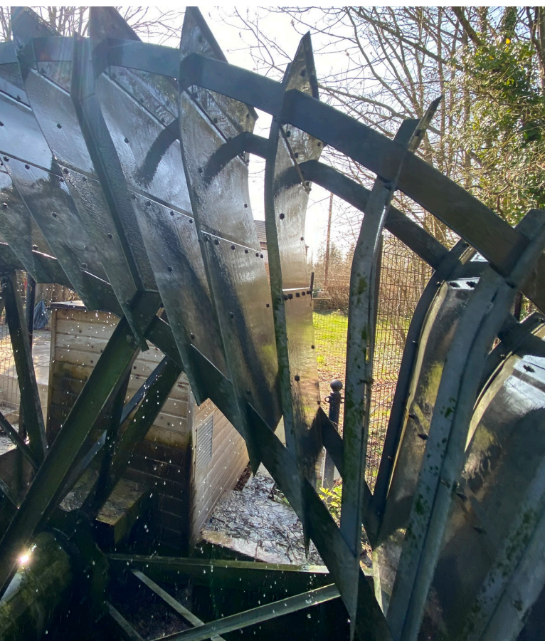
© CUA - installation hydro-électrique à Goeulzin
