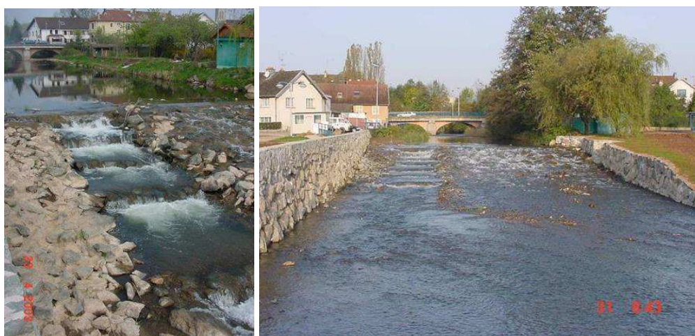
Figure 30 : Rampe en enrochements sur la Savoureuse (90, SOGREAH 2003)
