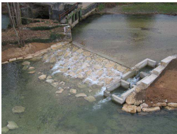
Figure 27 : Déversoir + passe à bassins successifs sur l'Ource (21, SOGREAH 2008)
