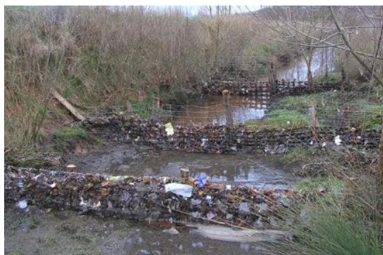
Figure 40 : Photo d'un "dégrilleur artisanal " installé en sortie d'un exutoire pluvial sur le ruisseau de l'Auterne afin de piéger une partie des déchets
