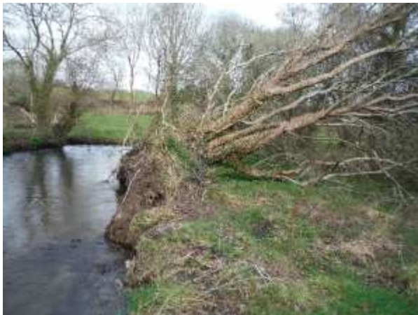
Souche à repositionner pour éviter une érosion l'amont immédiat d'un pont
