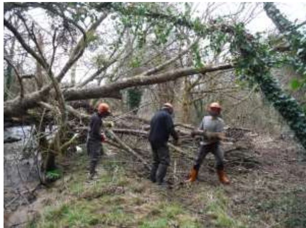
Dégagement d'un amas de branches cassées présentant à un risque pour la sécurité
