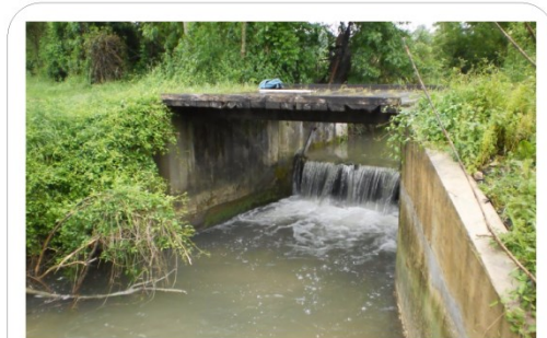
Ouvrage n° 30: Clapet Caractéristiques de l'ouvrage : Longueur : 6 m Largeur : 3 m Hauteur : 2,6 m Gestion : publique
