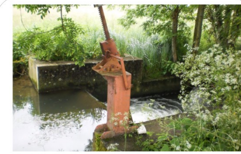
Ouvrage n° 11 : clapet Caractéristiques de l'ouvrage : Longueur : 6 m Largeur : 3 m Hauteur : 2,5 m Gestion: publique
