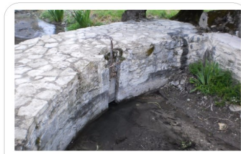
Ouvrage n° 24: Vanne Caractéristiques de l'ouvrage : Longueur : 1,5 m Largeur : 3 m Hauteur : 1,1 m Gestion : publique
