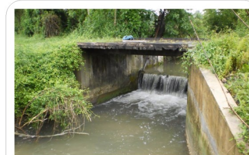
Ouvrage n° 30: Clapet Caractéristiques de l'ouvrage : Longueur : 6 m Largeur : 3 m Hauteur : 2,6 m Gestion : publique
