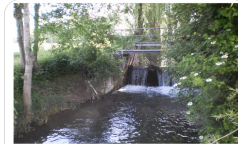
Ouvrage n° 16 : Clapet Caractéristiques de l'ouvrage : Longueur : 1,2 m Largeur : 6 m Hauteur : 2,2 m Gestion : publique
