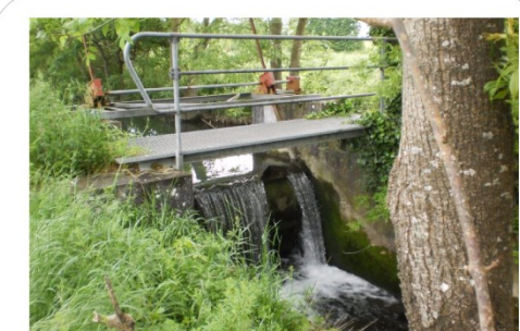
Ouvrage n° 12 : clapet Caractéristiques de l'ouvrage : Longueur : 5 m Largeur : 3 m Hauteur : 2,9 m Gestion : publique
