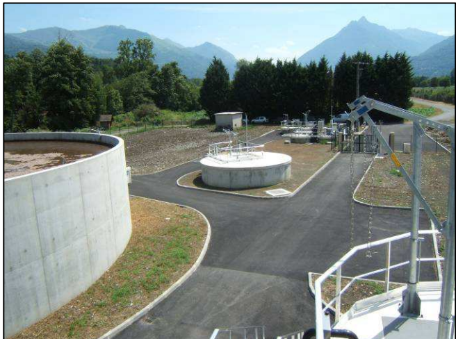
Nouvelle STEP d'Argelès-Gazost (2007)
