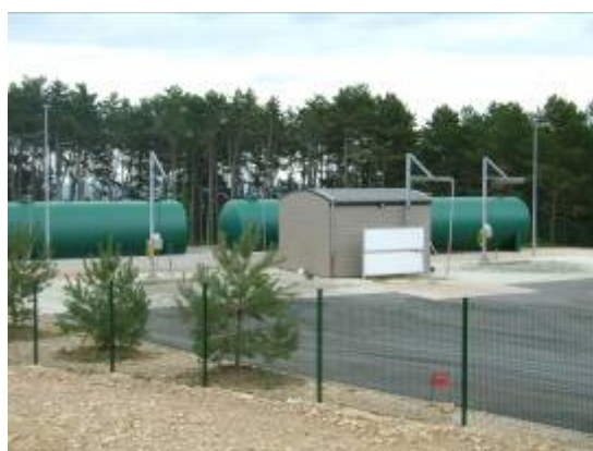
Photo 2 : l'aire de lavage des pulvérisateurs (Volnay)
