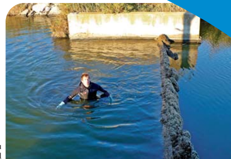
Nettoyage du barrage anti-sel
