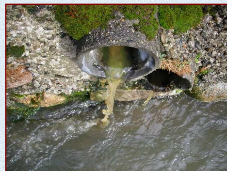
Assainissement non collectif non conforme
