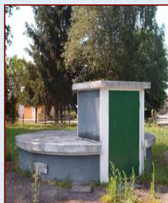
Captage d'eau potable
