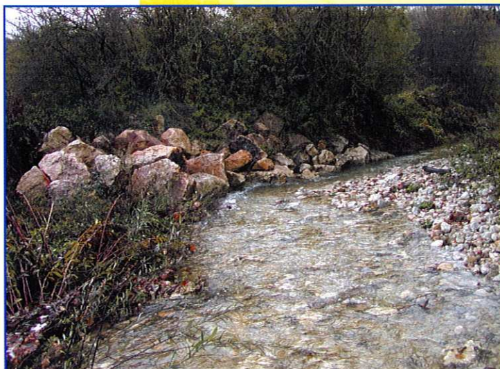
Enrochements mal positionnés à Hauteville-Lompnes
