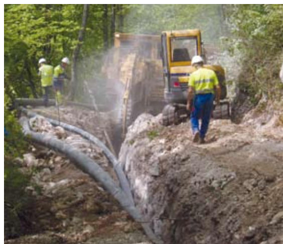
Descente des effluents Des Déserts
