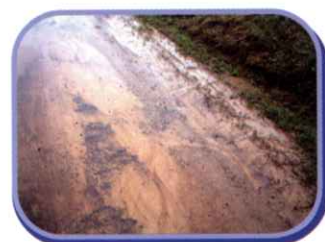
Sol "décapé" suite à une forte pluie coulant sur la route Février 2003
