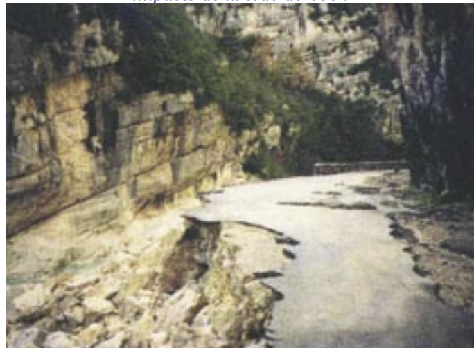
Impacts de la crue de 1994
