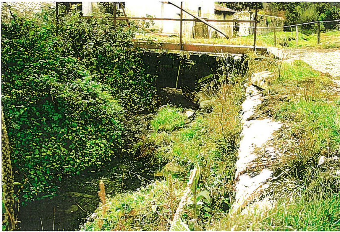
L'Egotay : passerelle en mauvais état vers Val Ronzière
