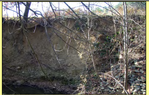
Erosion des bords
