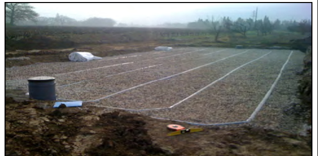
Lit d'épandage (cliché SPANC66)
