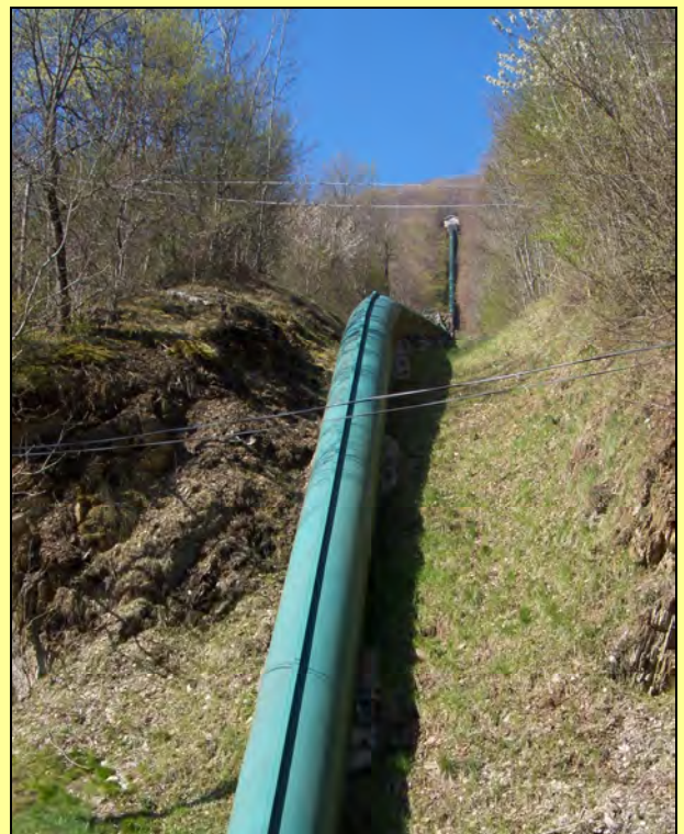
Conduite forcée à Usson
