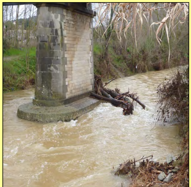
Embâcles sous un pont
