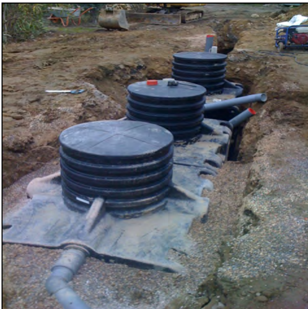
Fosse toutes eaux et filtre compact (cliché SPANC66)
