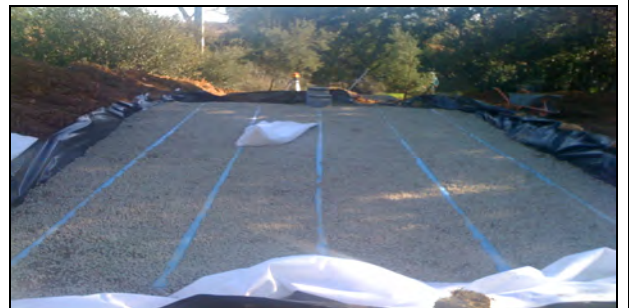
Filtre à sable drain (cliché SPANC66)
