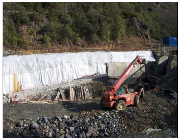
Passes à poissons en construction à la prise d'eau de la Forge à Quillan
