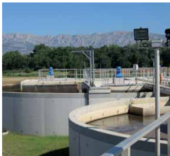
Station d'épuration de Trets
