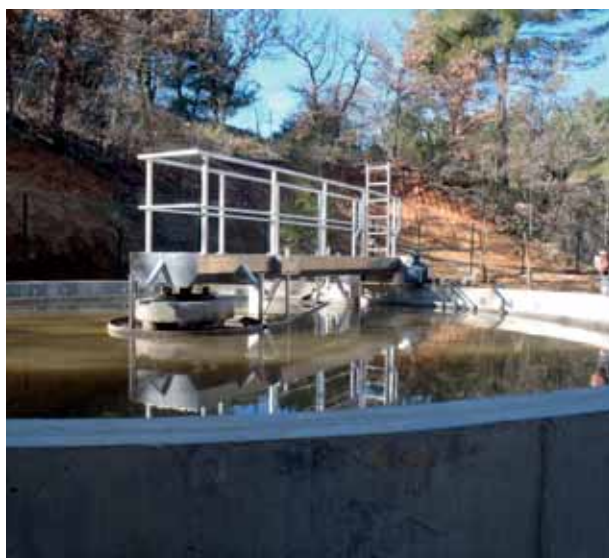
Station d'épuration de Châteauneuf-le-Rouge - Mise en service en 2011
