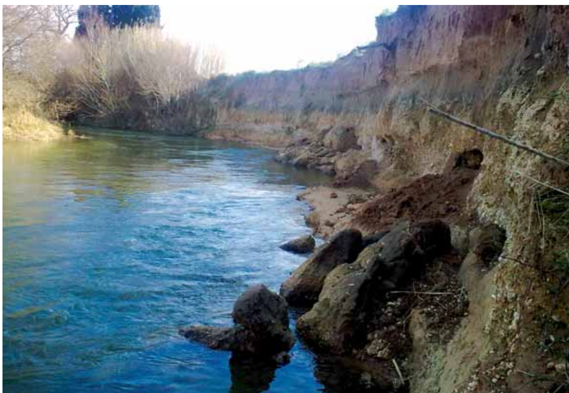
Érosion sur l'Arc à Berre-l'Étang, 2011
