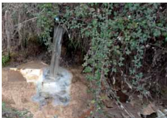
Rejet de la station d'épuration de Pourrières
