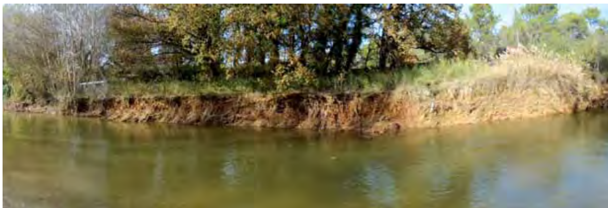
Érosion sur l'Arc à Aix-en-Provence, 2012
