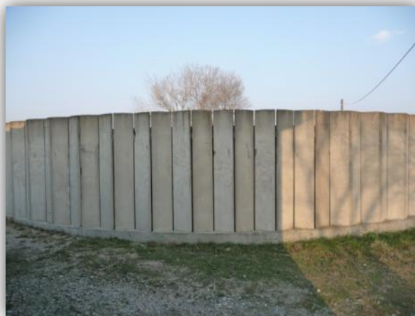
Figure 32 : bâche de stockage d'eau potable
