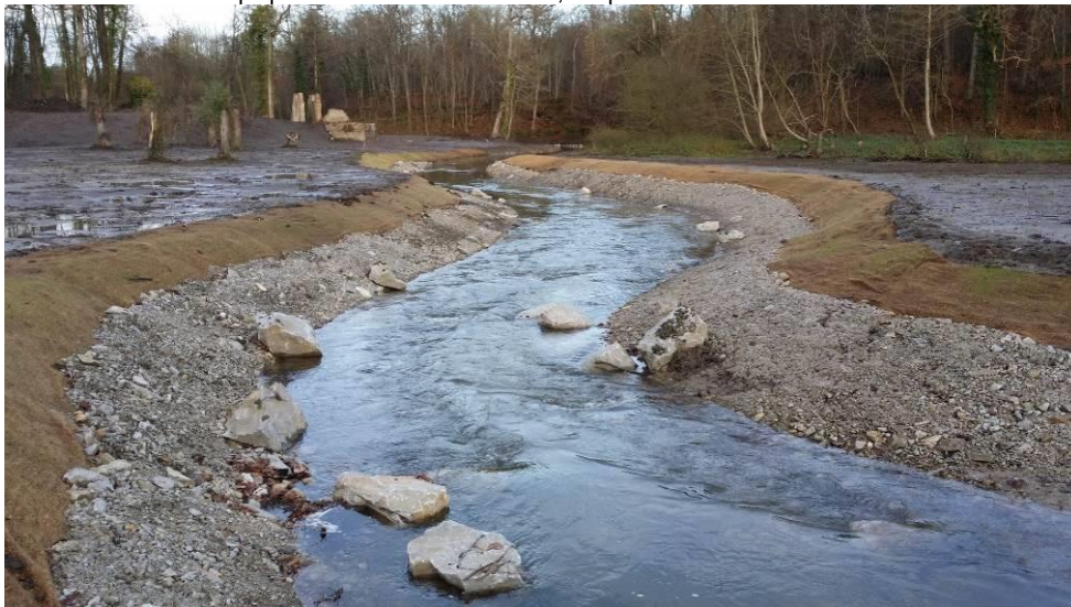
Figure 2: Exemple de remise en fond de vallée du nouveau lit de l'Iton (27) en cours de chantier, à l'étiage
