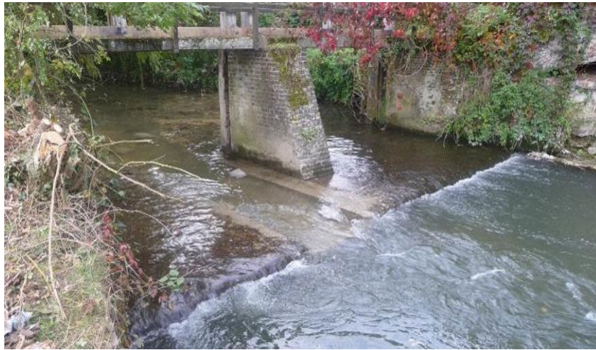
Figure 4: Exemple d'échancrure en V sur le radier du seuil sur la Blaise (28)
