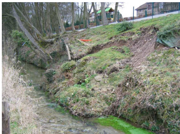
Effondrement de berges
