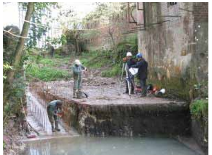
Construction de la passe à poissons vue de l'aval (Crédit photographique : S.M. SAGE Canche)
