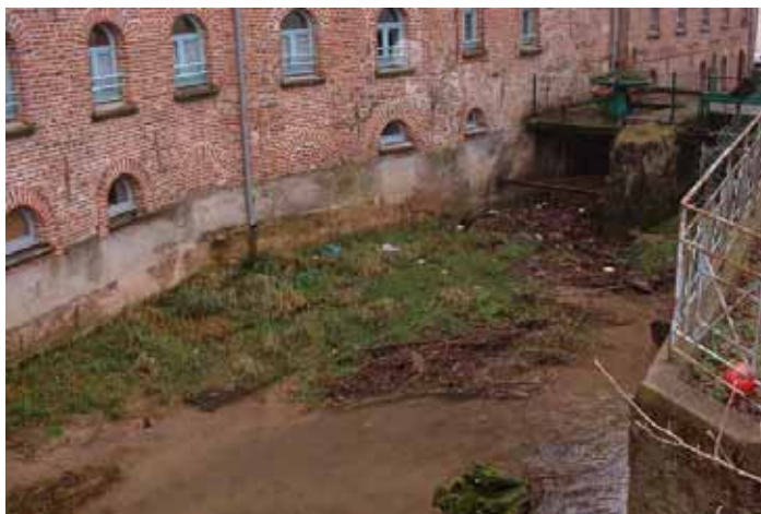
Figure 1 : ouvrage faisant obstacle à la continuité écologique, vu de l'amont - accumulation de sédiments (Crédit photographique : S.M. SAGE Canche)
