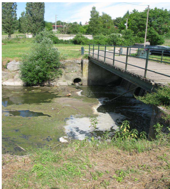
Rejet d'une station d'épuration dans l'Yerres
