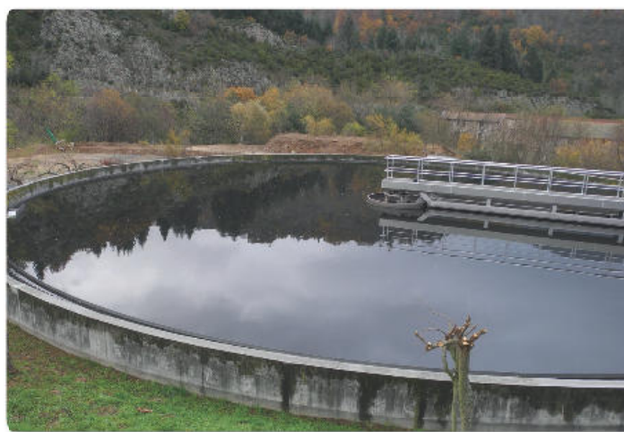
Assainissement collectif : clarificateur d'une station d'épuration de type "boue activée"
