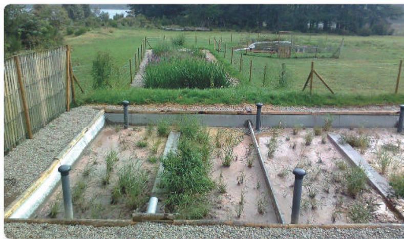
Assainissement autonome : lit planté de roseaux
