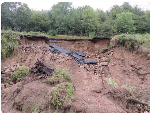
Effondrement suite aux fortes pluies
