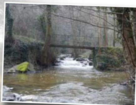
Ouvrage vétuste sur le Batalon - Malleval
