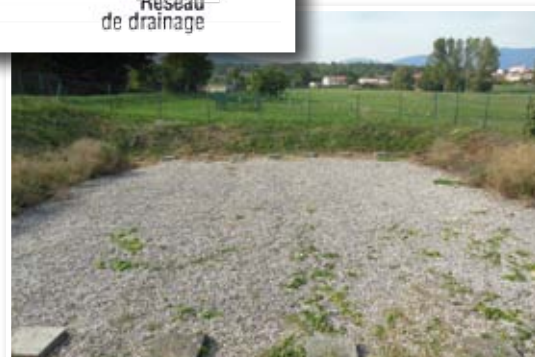
Filtre à sable à Pélussin
