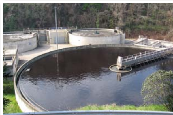
Station d'épuration de type boues activées à Annonay
