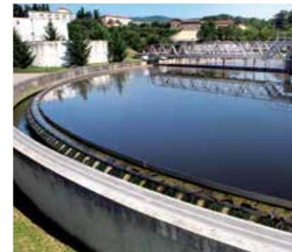
Station d'épuration La Maladière à Saint-Chamond © Saint-Étienne Métropole / Hubert Genoulhac / photupdesign
