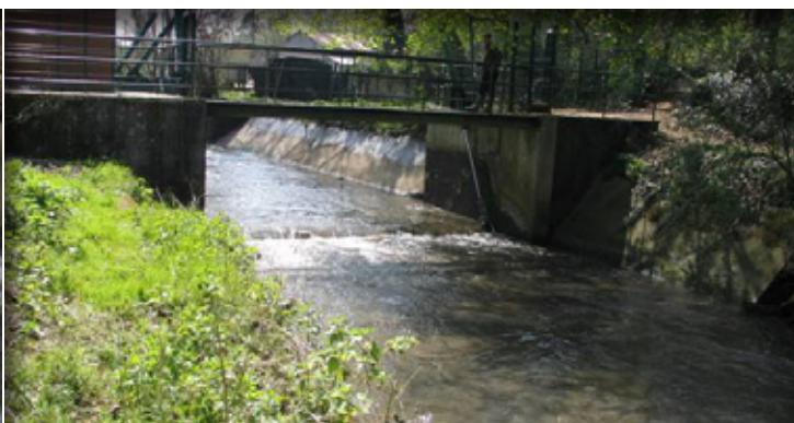
Le même clapet abaissé depuis mars 2010
