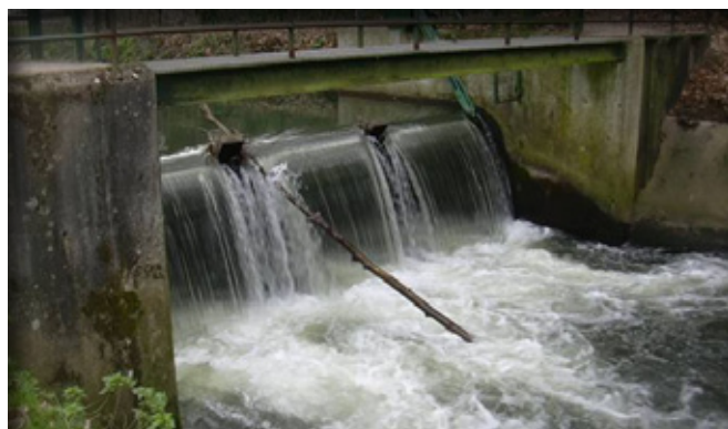
Le clapet de Souchard avant abaissement
